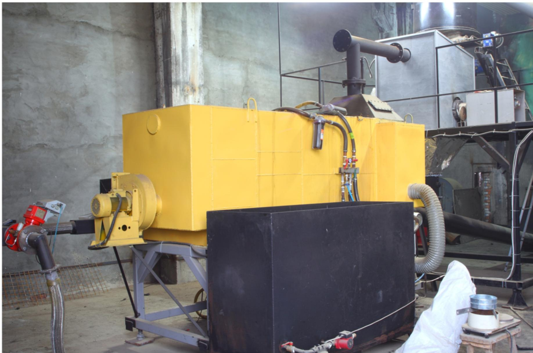
Блок очистки синтез газа (скруббер)
